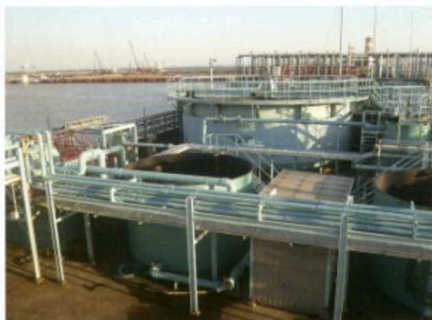
排水処理施設
